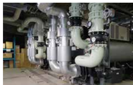
川越工場：高効率冷凍機
