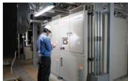
美里工場：温冷水ヒートポンプ
